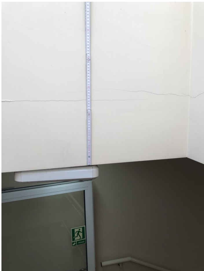
Fot.3 Lokalne zarysowania stropodachu nad klaką schodową w rejonie wjazdu dachowego
