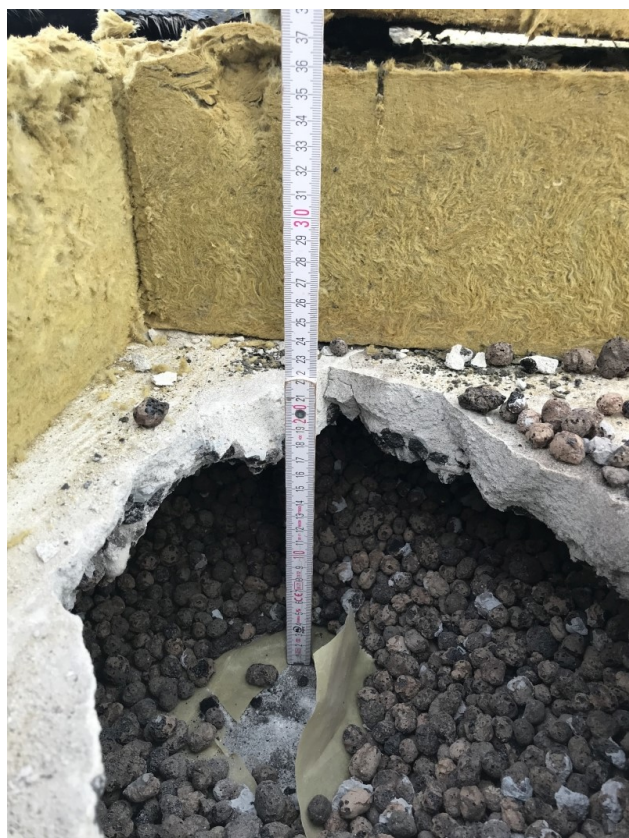
Fot.2 Odkrywka warstw spadkowych stropodachu na budynku 4 kondygnacyjnym – zmienna wysokość warstwy keramzytu
