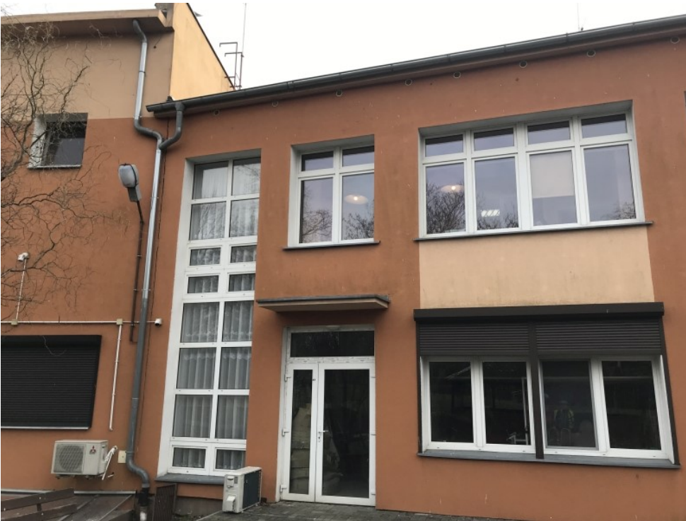
Fot.11 Pęknięcie na elewacji pomiędzy bud. 3 i 4 kondygnacyjnym.
